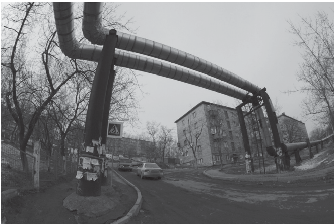
Las tuberías de agua caliente en Rusia ilustran un caso extremo de suministro centralizado obsoleto.
