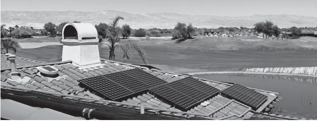
En este techo, un sistema térmico solar funciona junto con un sistema fotovoltaico.
